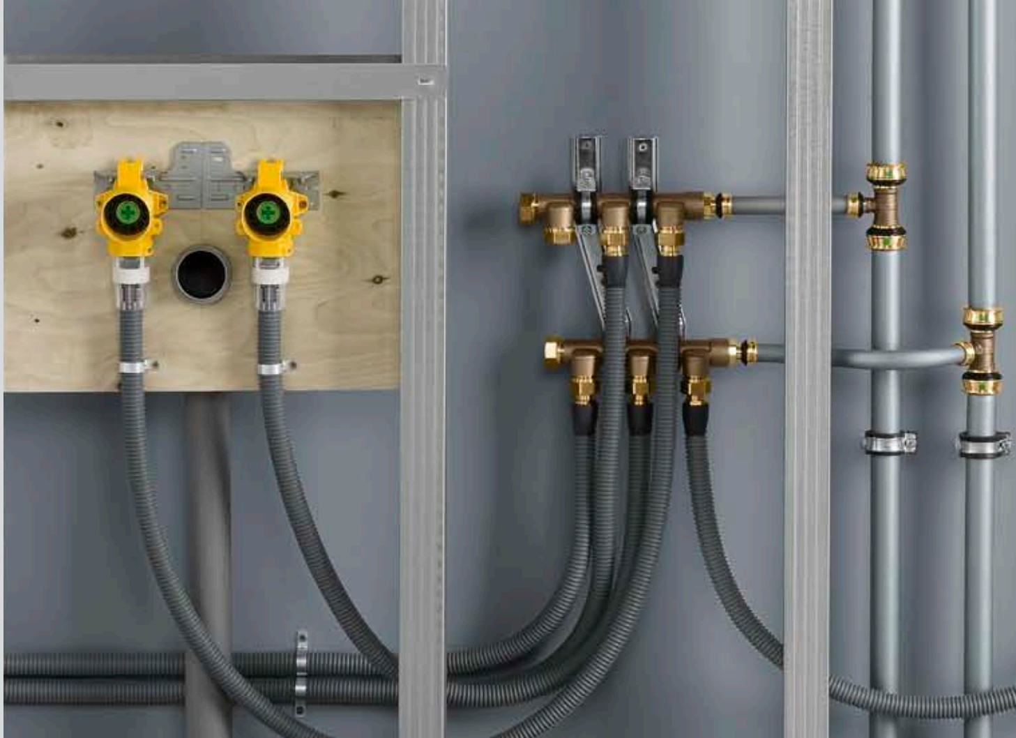
Drikkevandsinstallation med det nye Viega Combi PB. Nemt, hurtigt og sikkert!
